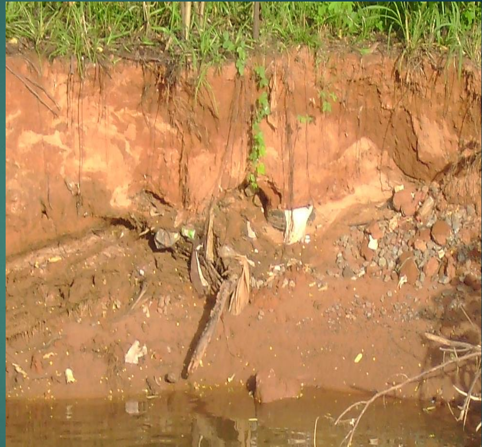
D. T. Fluvial – Córrego Neblina Jusante
