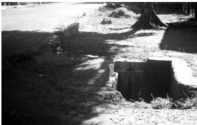
Figura 15: Água servida lançada na rede de esgoto Av. Araguacy
